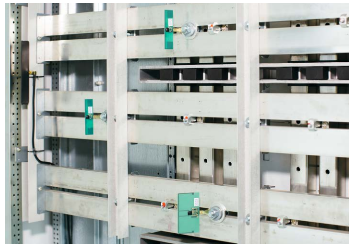
Das System funktioniert störungsfrei in metallischen Umgebungen.
